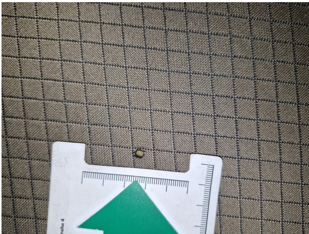
Viz popis k poškození č. 12
